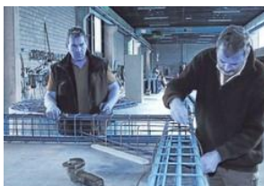
Witt-Mitarbeiter arbeiten an einer Bewehrung. Damit wird das Stahlflecht bezeichnet, an dem der Beton sich "festhält".
